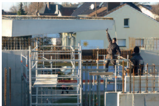
Die Arbeiten am neuen Gemeindehaus in Rheda gehen gut voran. (Foto: Finken)
